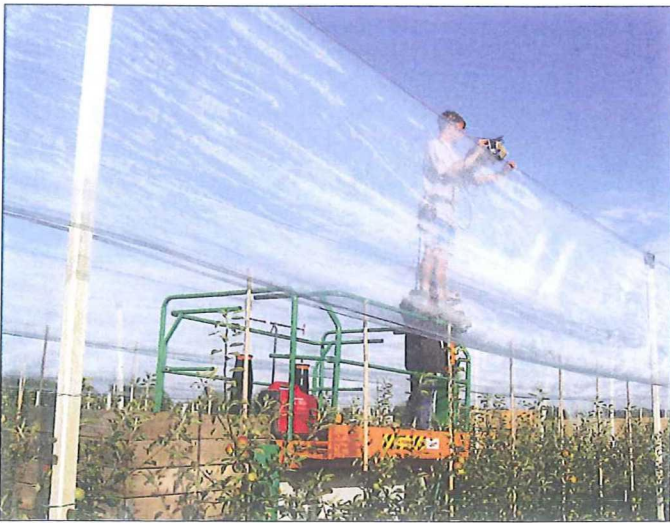
Voor het werk aan hagelnetten is een arbeidsplatform met een vloerhoogte van minimaal 2,25 meter nodig. Foto: Peter van Arkel / Fruitadvies Zuid-Limburg
